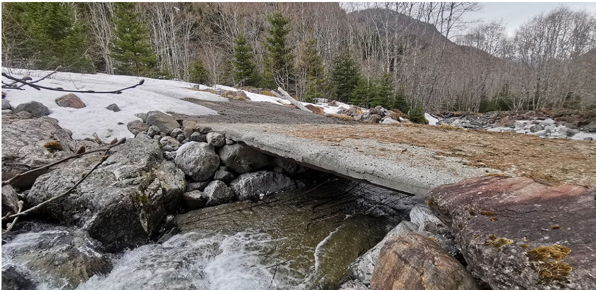
Figur 37: En stålbjelke bærer betongplata som sammen utgjør brukonstruksjonen over Turiddøla. Konstruksjonen er konstruert for og bærer preg av at den oversvømmes ved flom.
